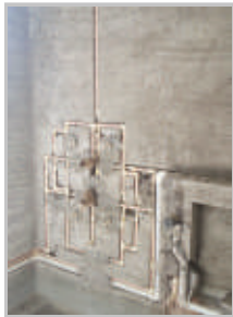
ACTUAL PLUMBING PHOTO
